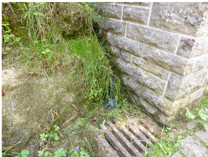
Wasseraustritt neben Quellgebäude III
